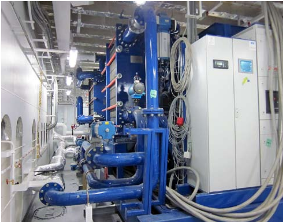
En Opcon Powerbox under installation ombord på ett av Wallenius LCTC-fartyg.
